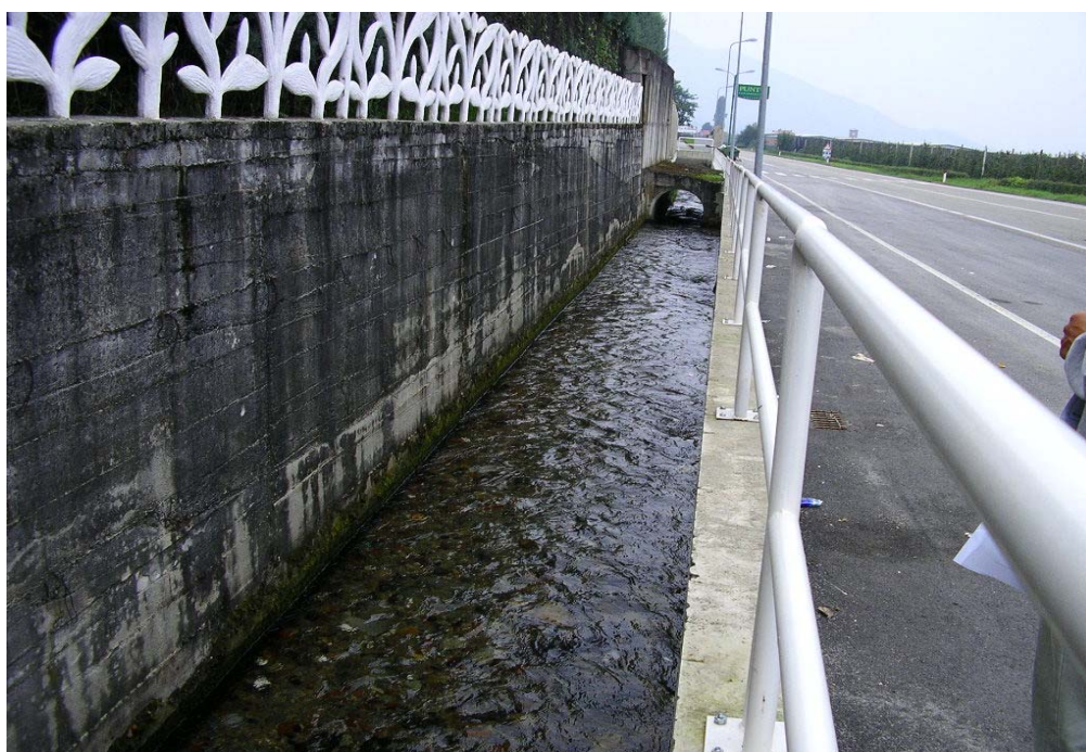
Foto 11 Bealera dietro il Castello nel tratto adiacente alla SP per Envie. Si noti la tombatura di diametro 110 cm. Poco a valle, la bealera si divide in due tubature di 60 cm (Sez. 90).
